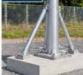
コンクリート基礎にアンカーボルトで 固定 (強風対策)
